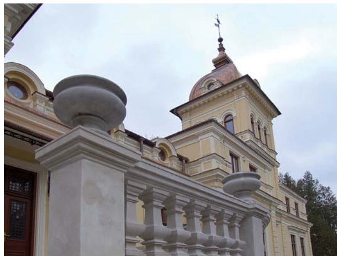
W ramach EFRR dofinansowano projekt: „Modernizacja dachu i elewacji zabytkowego pałacu w Kluczkowicach”
